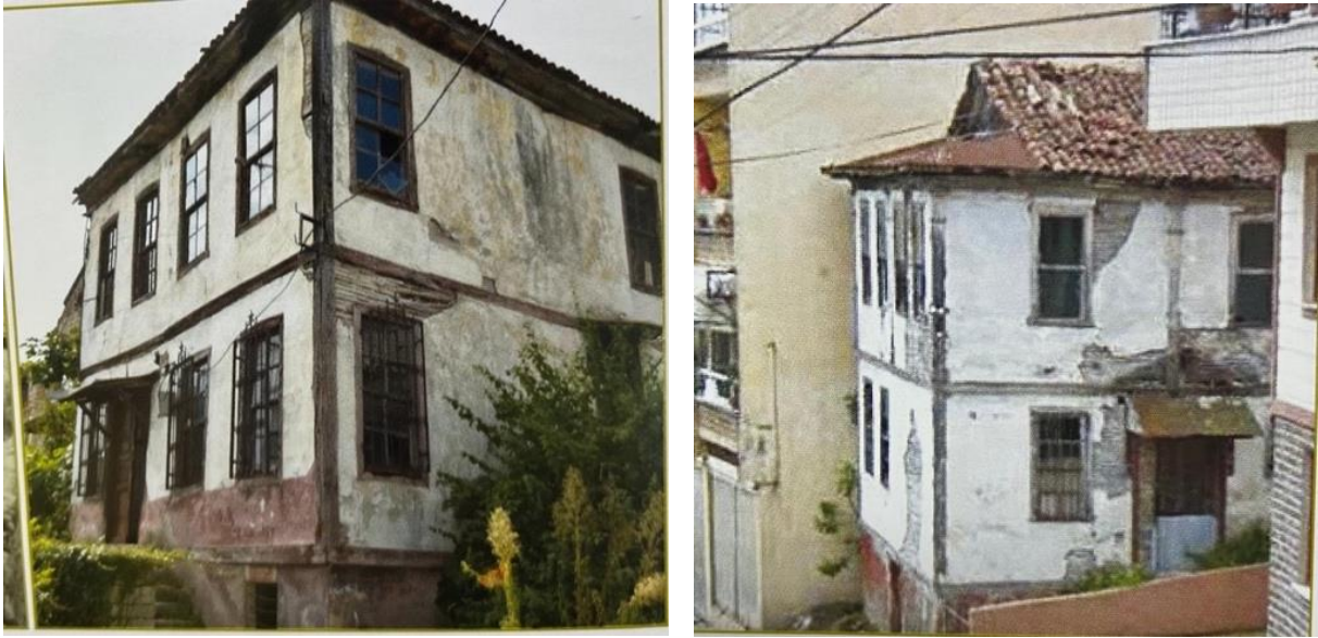
Görsel 12: Altınordu'da 514 Ada 5 Parselde ve 86 Ada 1 Parselde Bulunan Evin (Kültür Envanteri, 2019: 24, 100) İnşa Malzemesi.
